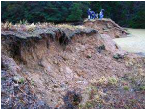
写真3 堤体下流斜面の崩落の様子
