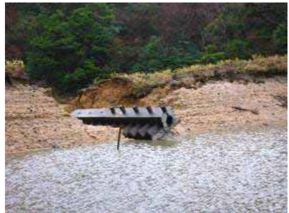
写真4 下流側から見た決壊状況 (中央は、斜樋)
