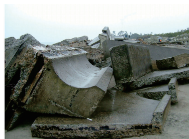
(b) 海岸堤防の破壊
