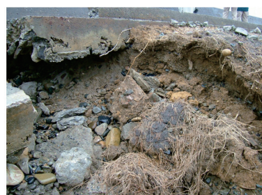
(d) 海岸堤防裏法の吸出し状況
