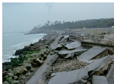
(a) 海岸堤防の破壊
