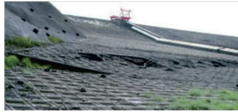
Fig. 15 川西ダムの上流斜面の被災状況 Damage of upstream slope
