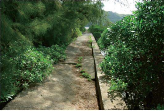
Fig.7 石積み海岸堤防の崩落（沖縄県） Cave-ins on stone wall coastal dykes (Okinawa prefecture)
