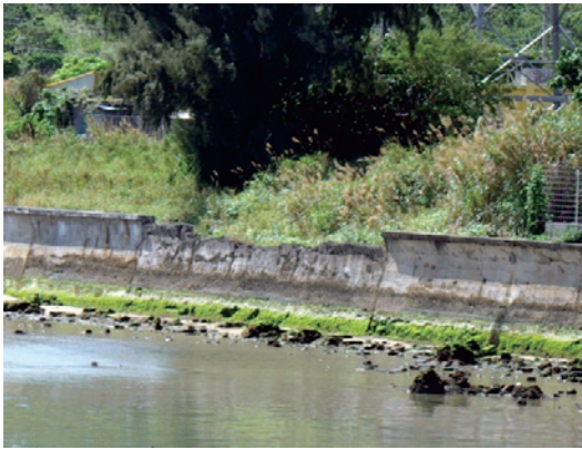
Fig.9 パラペットの崩落（沖縄県） Dispersion of parapet (Okinawa prefecture)
