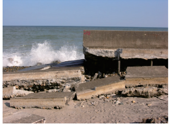
Fig.10 越流による堤防背後からの崩落（福島県） Collapse of coastal dykes by overflow from behind Fukushima prefecture)
