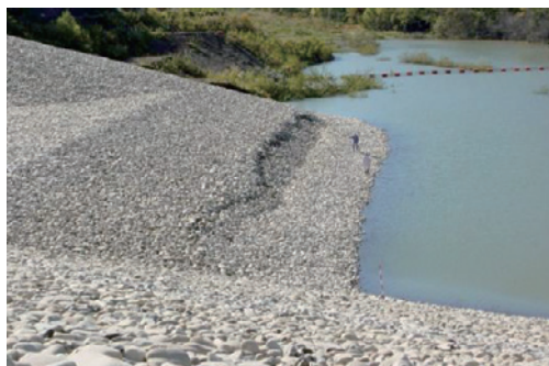
Fig. 10 右岸地山ブランケット保護層の被災 Damage of protective layer of blanket at right abutment
