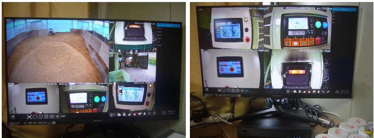
図3 遠隔監視モニターによる各稼働状況の表示例
