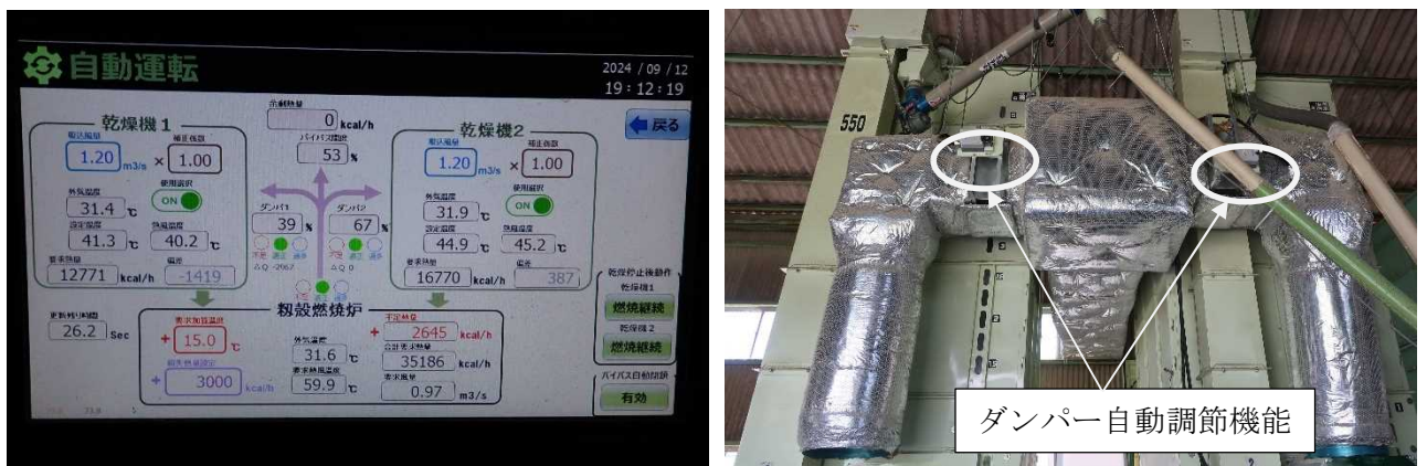
図2 籾殻燃焼装置と各乾燥機との稼働状況確認画面と温風ダクトに追加したダンパー自動調節機能
