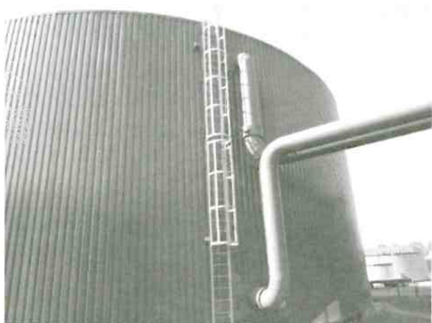
図7 CHPシステムと連動させて用いる温湯タンク
