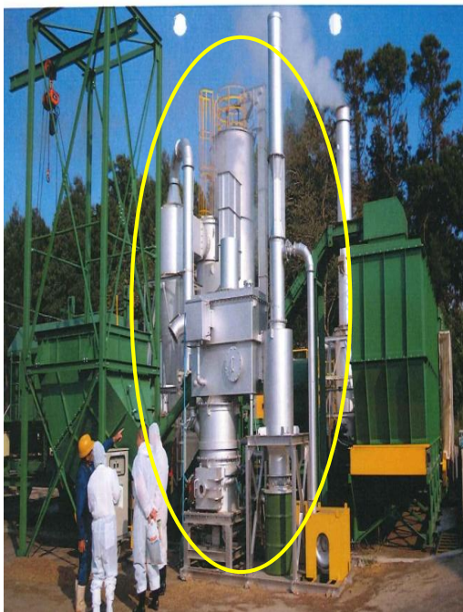
＜小型バイオマス温水ボイラ外観＞
