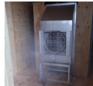
写真 1 断熱庫内の蒸熱処理装置 断熱庫内でミスト散水とヒーターにより定植苗を 50℃まで加熱
