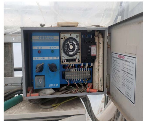
写真1 既存の制御装置
