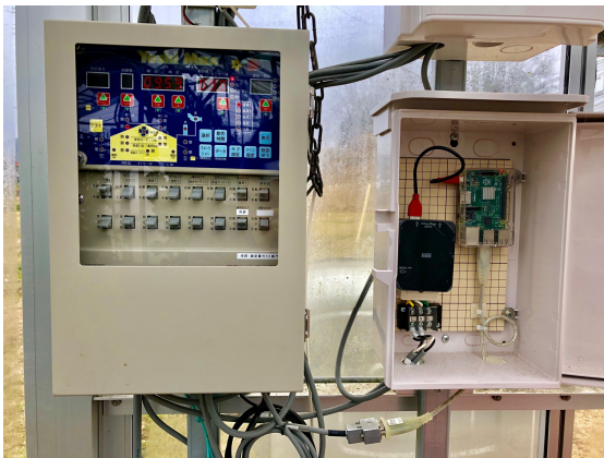
写真1 三基計装(株)と(国)岡山大学によってUECS対応にリニューアルされ、ヒートポンプ冷房用ロジックを搭載した統合環境制御装置(YoshiMax)と制御用のマイクロコンピューターの外観
