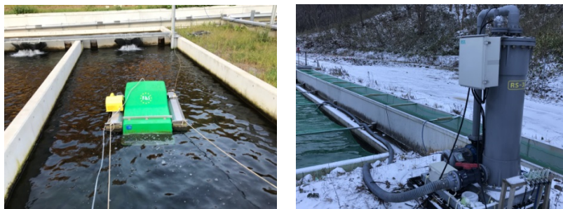
図2. 酸素溶解装置：水上設置タイプ(左)、陸上設置タイプ(右)
