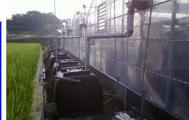
雨水貯留タンク
