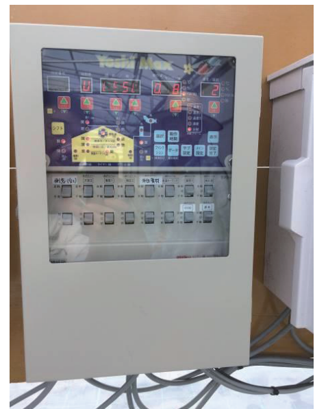
図4 複合環境制御装置 YoshiMax
