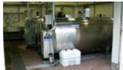
図3 実用化試験を行った原乳タンク
