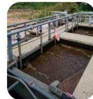
検証実験予定の活性汚泥処理施設の曝気槽（約50m 3 ）
