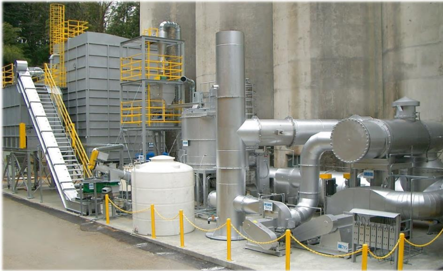
籾殻炭化排熱籾乾燥利用システム JA石川かほく様 平成19年
