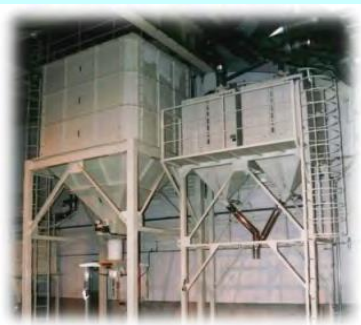
穀物貯留乾燥設備
