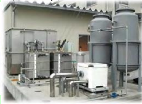
廃水处理装置
