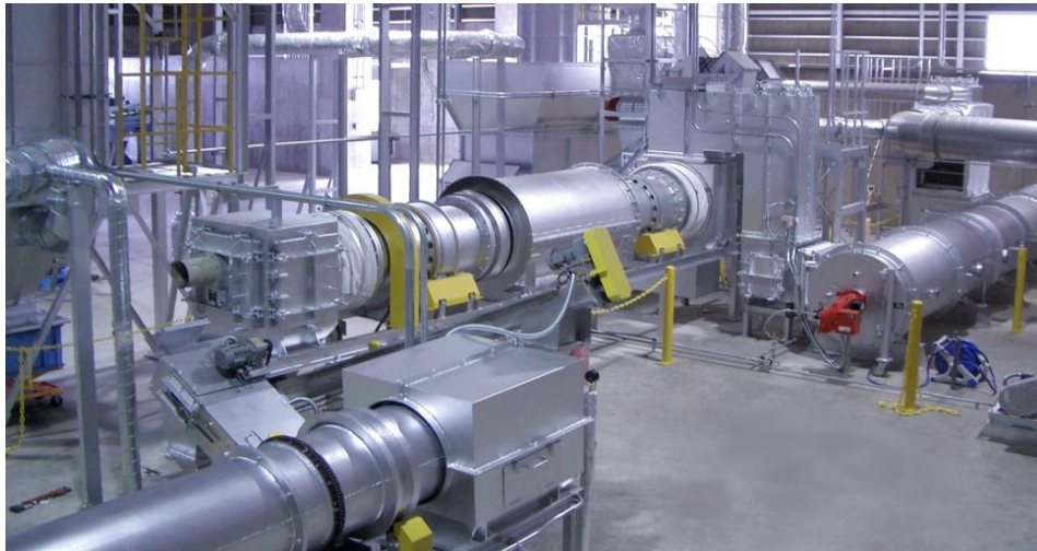
木質チップ炭化設備 富山市（旧八尾町） 平成17年
