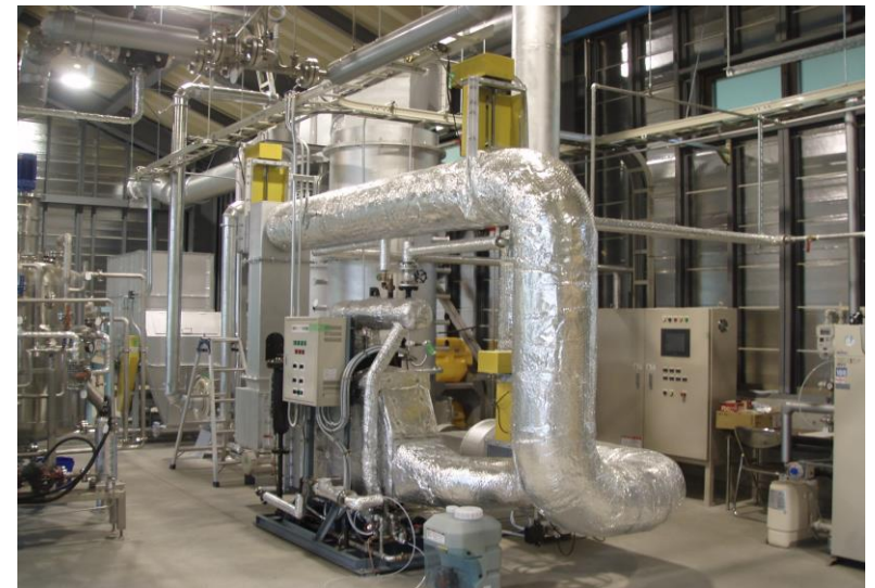
バイオマスボイラー 東京大学生産技術研究所 平成19年
