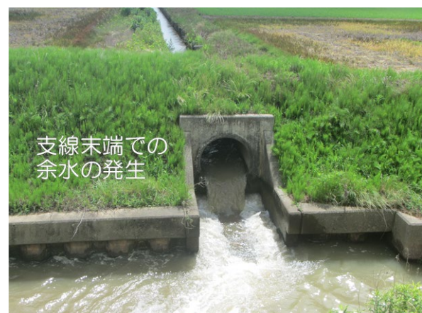
写真 1 水路末端からの余水状況
