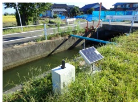
写真 2 開発した水管理システムの監視子局
