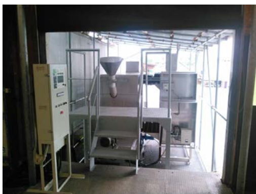
写真1 水産加工業者に設置した飼料化装置
