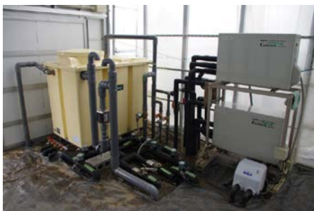
写真 1 地下水熱源ヒートポンプシステム
