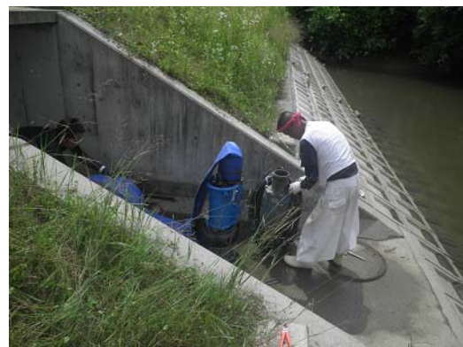
写真-6 調査時のポンプの設置状況
