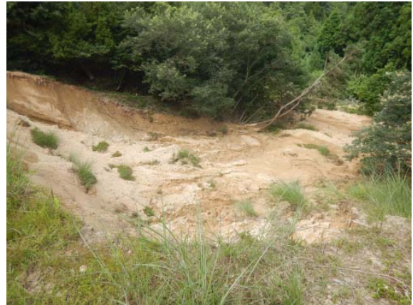
写真-18 崩壊箇所（写真-17の下部）
