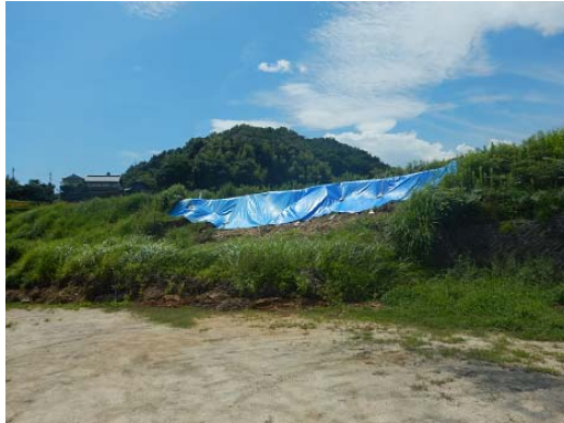
写真-1 1 下流側正面堤体の表層崩壊
