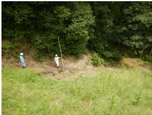
写真-3 堤体崩壊部 堤体中央上部から左岸側を撮影
