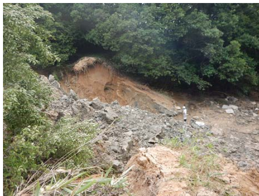
写真－9 堤体右岸側から決壊部を撮影
