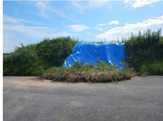
写真-1 2 左岸側堤体の表層崩壊
