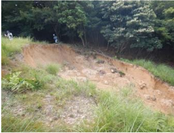
写真－19 堤体天端から左岸側崩壊部を撮影
