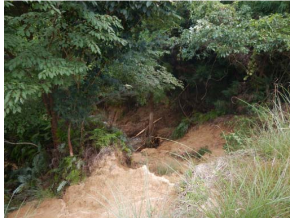
写真－20 堤体天端から右岸側崩壊部を撮影
