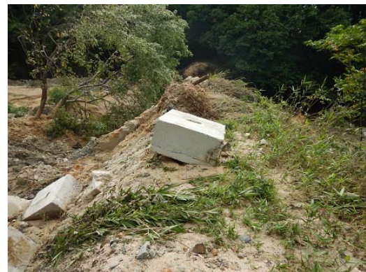
写真－8 堤体右岸側から撮影 天端にコンクリートブロック等が堆積する
