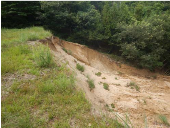
写真-17 崩壊箇所（上部）
