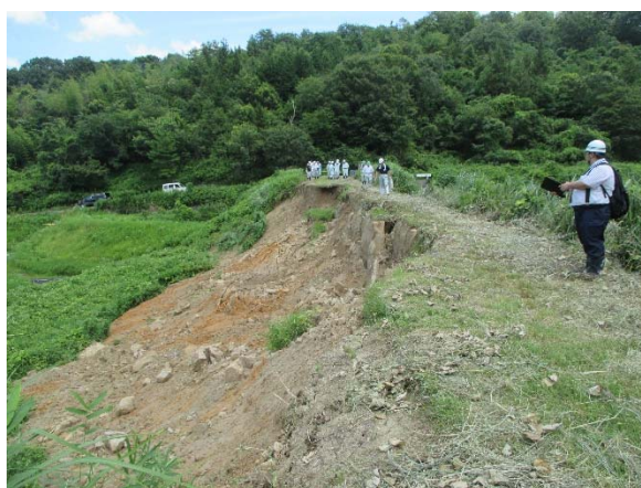
写真-8 堤体崩壊部 堤体左岸より望む
