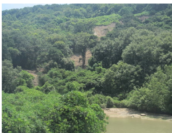
写真-10 貯水池上流山腹土砂崩壊部
