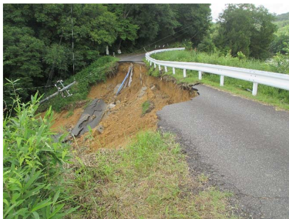
写真-4 堤体崩壊部 堤体左岸より望む
