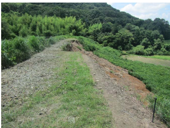
写真-9 堤体崩壊部 堤体右岸より望む
