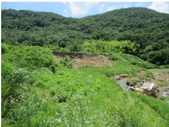
写真-7 体崩壊部 堤体右岸下流より望む
