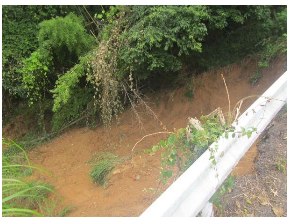
写真-13 堤体崩壊部 堤体天端左岸側から望む
