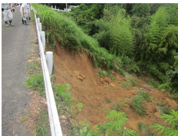
写真-14 堤体崩壊部 堤体天端右岸側より望む
