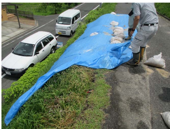
写真-9 堤体直下市道の浅いすべり
