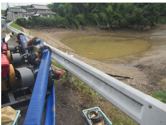
写真-15 貯水池の水位低下状況 堤体左岸より貯水池を望む
