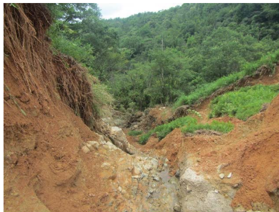
写真-4 堤体決壊部 決壊部から下流へ望む
