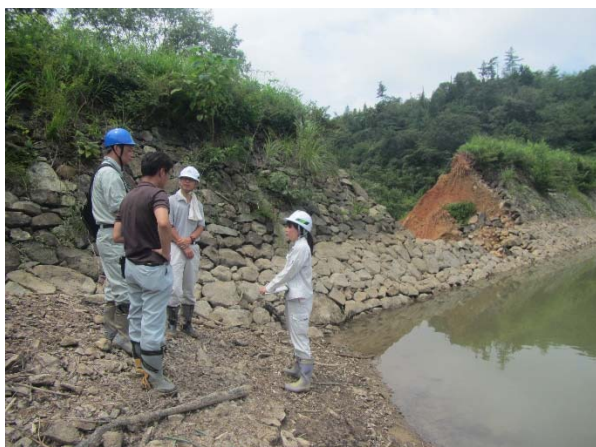
写真-5 堤体決壊部 貯水池上流左岸側から望む
