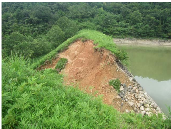
写真-3 堤体決壊部 堤体左岸より望む
