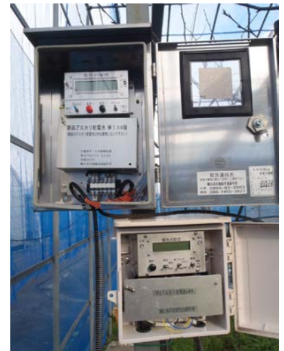
図3 散水制御システム
