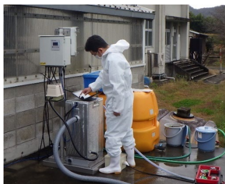
写真2 鳥取県中小畜産試験場における BOD 監視システムの設置調整作業（山形東亜 DKK 株式会社提供）
