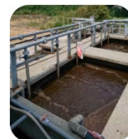
検証実験予定の活性汚泥処理施設の曝気槽（約50m³）
