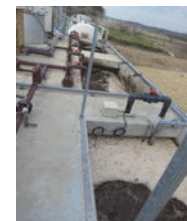
検証実験予定の養豚農家の活性汚泥処理施設の曝気槽
