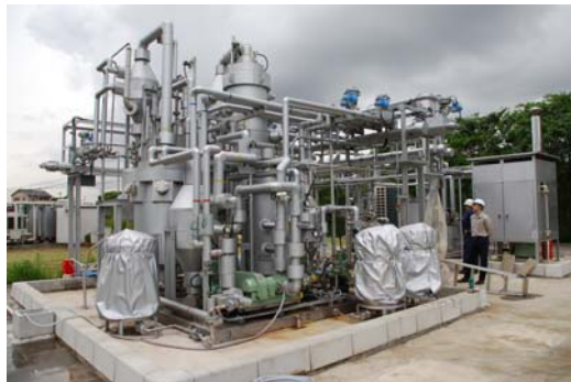
図2 ディーゼル代替燃料製造実証化プラント(400L/日)
