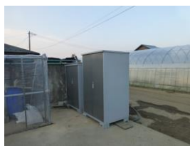
8インチRO装置と汲上ポンプ
