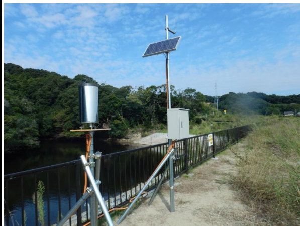
水位計+雨量計、転倒マス
