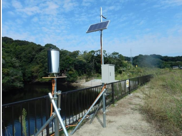
水位計+雨量計、転倒マス
