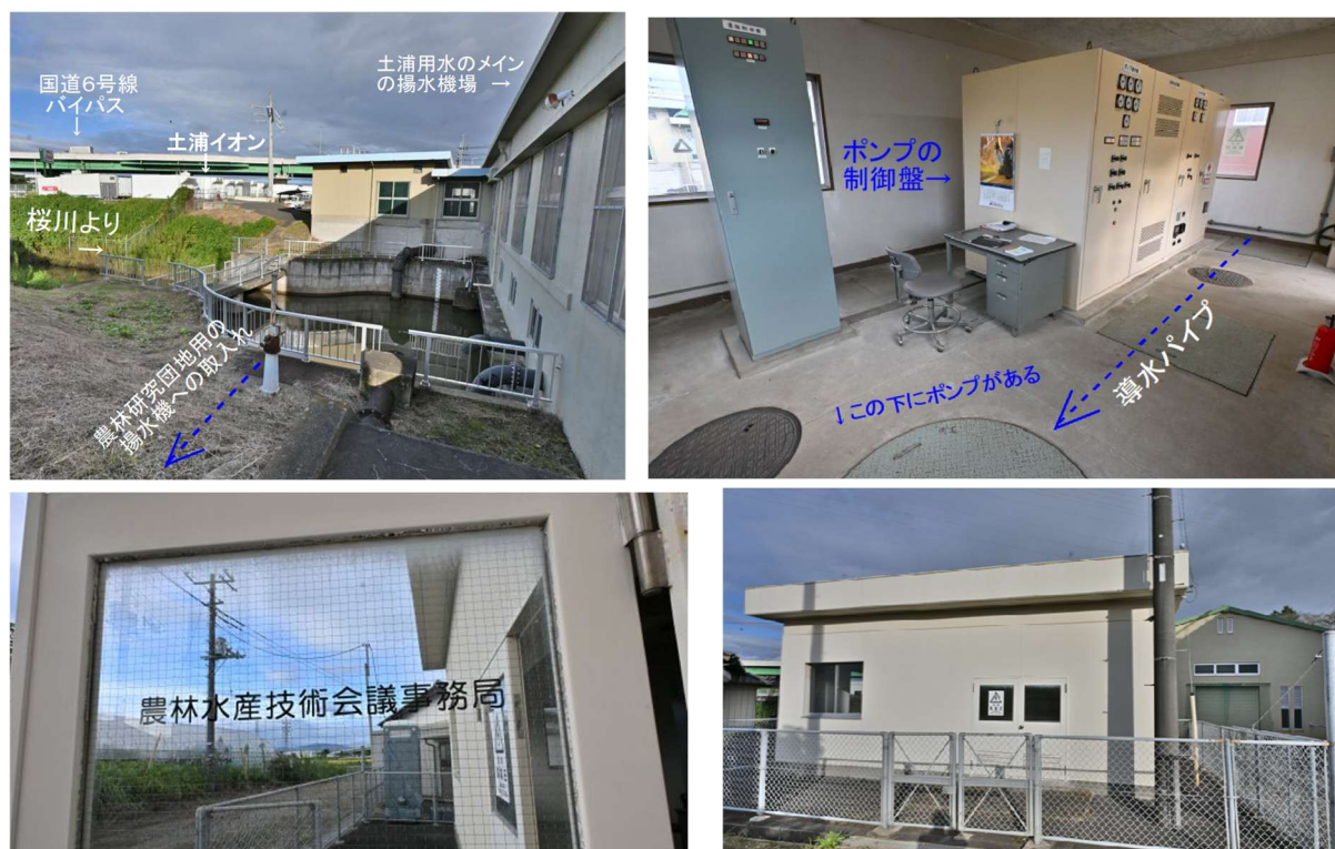
図15 非灌漑期に農林研究団地の用水をくみ上げる補助揚水機場
