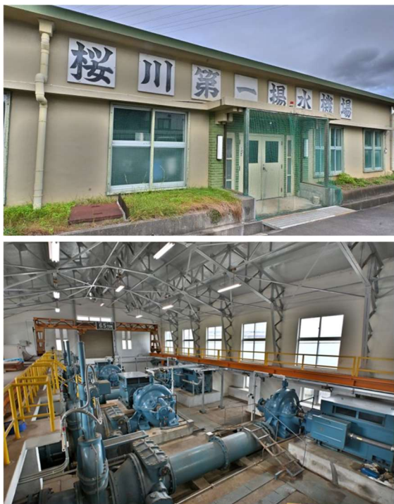
図13 土浦用水の揚水機場 【地理座標】36.0773, 140.1768
