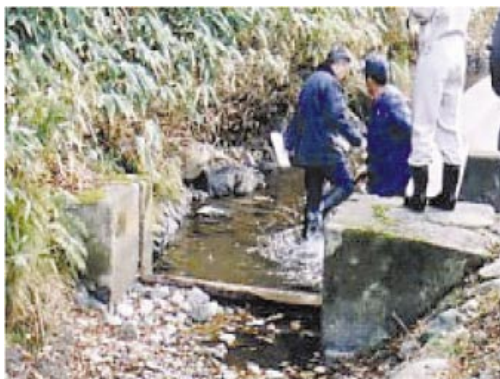
Fig.2 溪流取水工の取入れ口 (鳥取県日南町宮内東井手地区)
