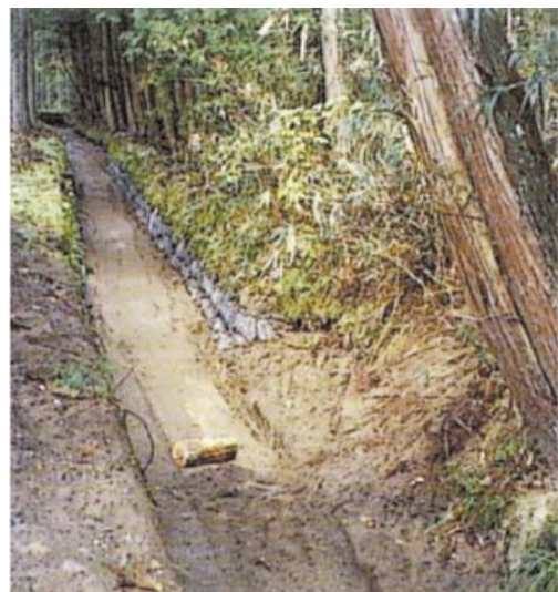
Fig.1 水路に流入した土砂
