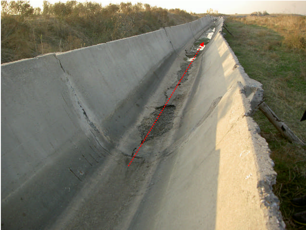
Fig. 12 管底縦断方向へのひび割れ
