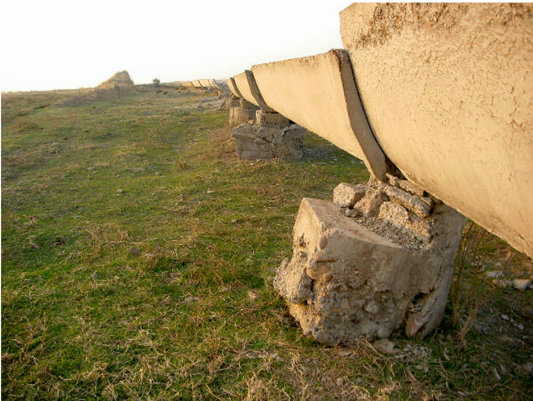
Fig. 15 基礎の傾き，増厚による支柱の偏心
