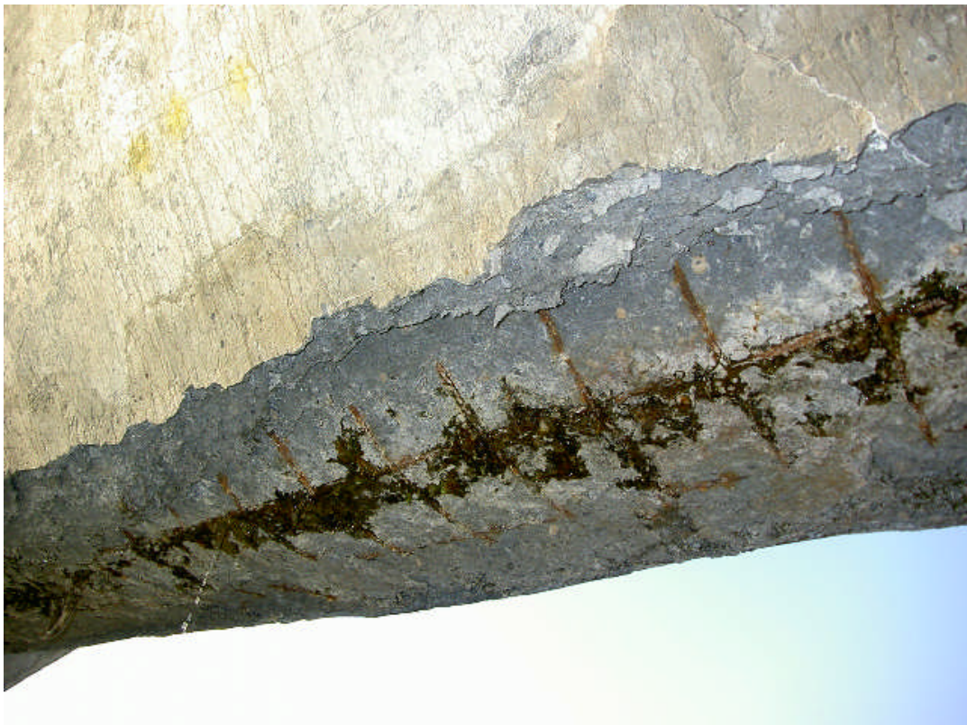
Fig. 13 管下面の鉄筋露出
