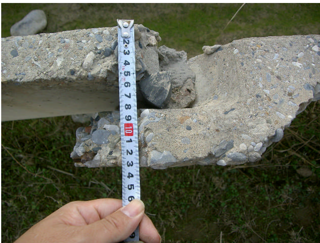
Fig. 17 継目の構造（受け口が抜け出し、止水ゴムの位置はずれている）
