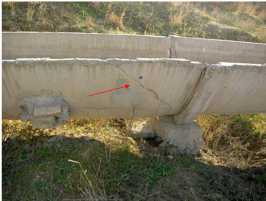
Fig. 11 受け口のせん断ひび割れ
