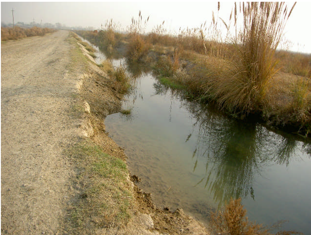
Fig. 7 コンクリートライニングの消失
