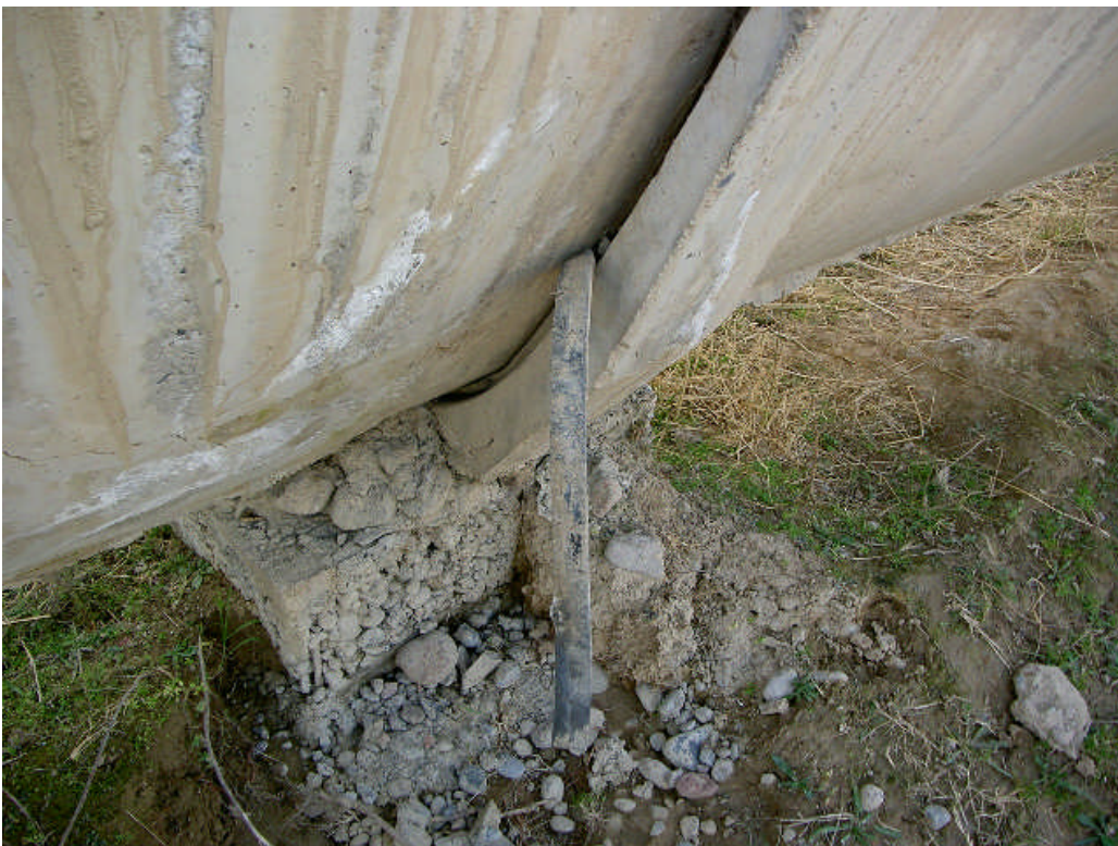
Fig. 19 止水ゴムの脱落
