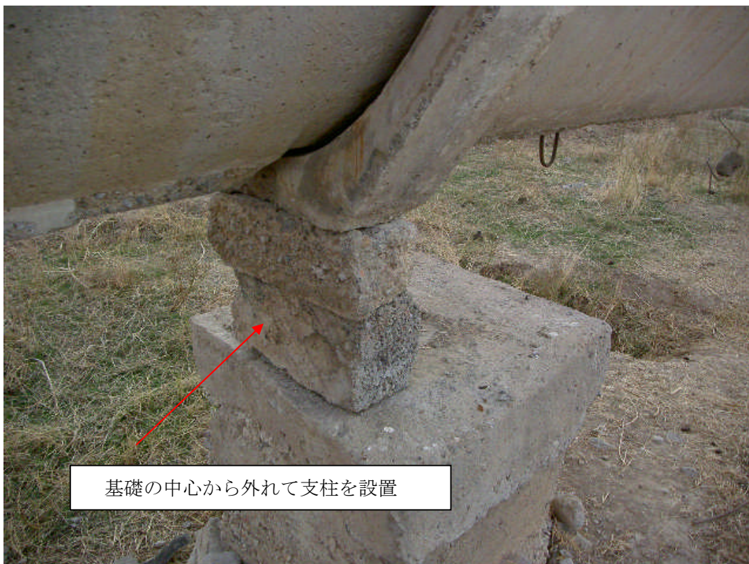
Fig. 16 不安定な支柱（コンクリート片を積み重ねただけかつ偏心）
