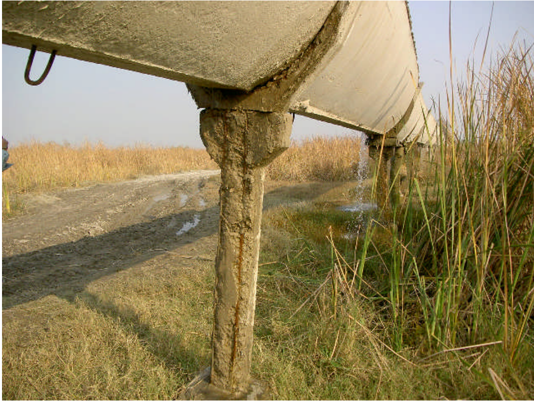
Fig. 14 細すぎる支柱，傾き，鉄筋露出
