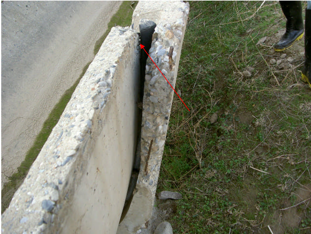
Fig. 18 継目の損傷（継目が変形し、止水ゴムが圧縮されていない）
