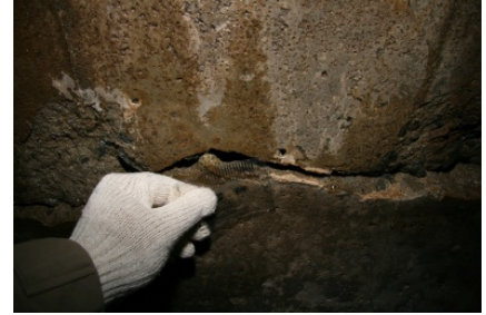
▲水路トンネル天端付近の開口ひび割れ
