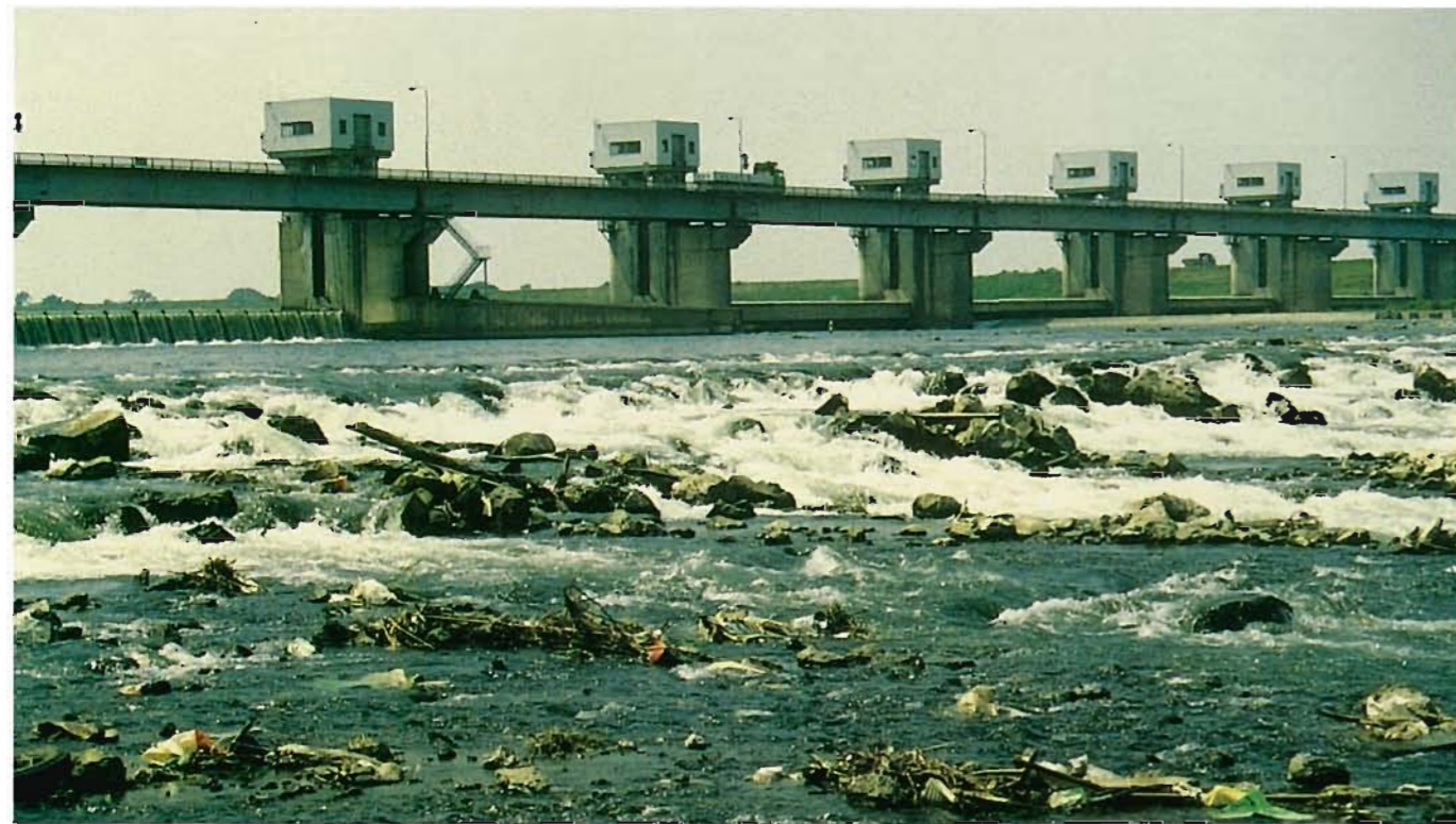
改修前の利根大堰下流護床工 (利根川の河床低下によって、下流護床工との間に平均3m~4mの段差ができていた。)
