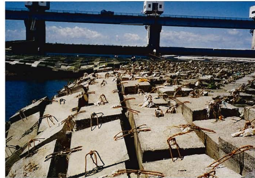
十字ブロック及び長方形ブロックの沈下状況及び破損状況
