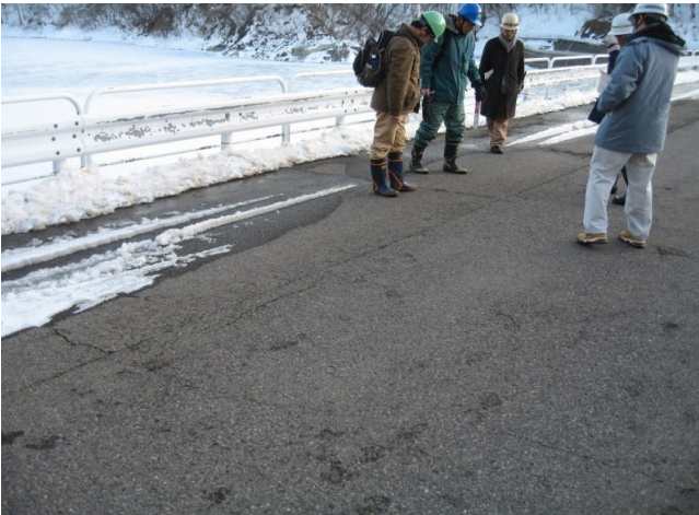
【長期供用アースフィルダム(福島県)の被災状況】 堤頂の保護アスファルトに発生した亀裂(アスファルト施工継ぎ目の箇所での離脱)を確認。
