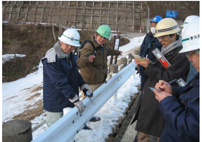
【堤頂部の開口状況の確認と今後の変状の確認方法等の助言】 調査員の足下のガードレール基礎と天端保護アスファルトの接続部に離脱開口の変状が生じている。
