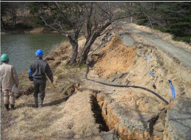
【堤体斜面が大きく崩落したため池の被災状況】 ため池堤体の天端に亀裂が発生。また、上流の法面にはすべりの発生が認められる。
