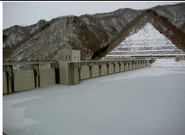
【コンクリートダム(福島県)の現地状況】 目視による点検を実施。その結果、堤体に変状は認められない。
