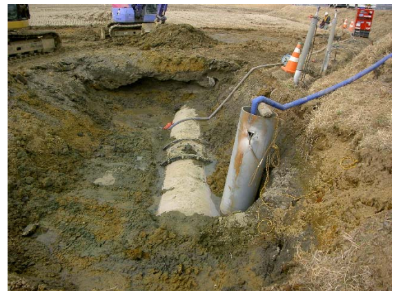
【(宮城県)農業水利事業管内でパイプ被災状況確認】 パイプライン直上の農道が沈下し、ひび割れも発生しており、開削してパイプの破損状況等を調査。周辺の地下水位が高く、暫定的な地下水排水によってパイプ本体の状況を確認し、パイプ内部からの漏水は見られず。
