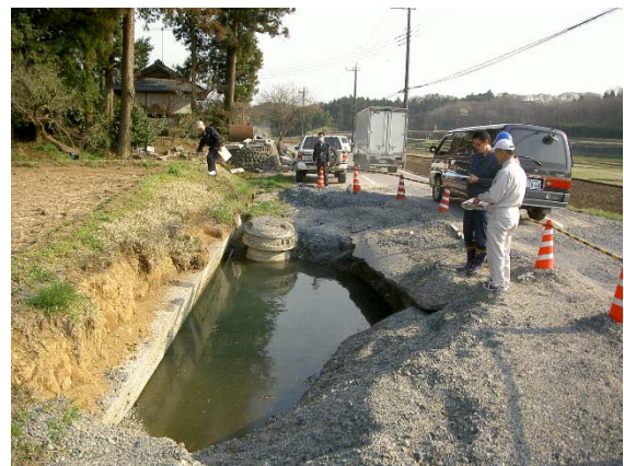
【パイプライン空気弁付近の塩ビ管継ぎ手の被災状況】 空気弁に接続する塩ビ管(TS継手)から漏水が発生。接着剤による継手接続が、地震時の地盤変位や空気弁工の変位にパイプが追従できず塩ビ管本体が破損した模様。
