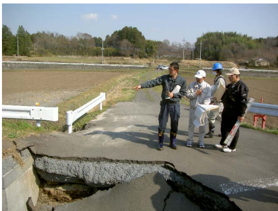
【パイプライン(栃木県)の曲り管部の被災状況】 構造物に接続する曲がり管部周辺で漏水が生じて道路が陥没。パイプ内部から継ぎ手部の状況を詳細に確認して、被害範囲の特定の必要があることを助言。
