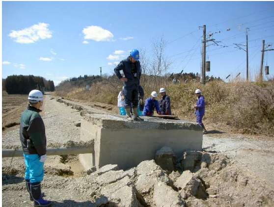
【パイプライン分水工(福島県)の被災状況】 道路下に埋設されていたパイプラインと空気弁工が大きく変状しており、浮上や蛇行量、たわみ量を計測し、全体の被害状況を確認。
