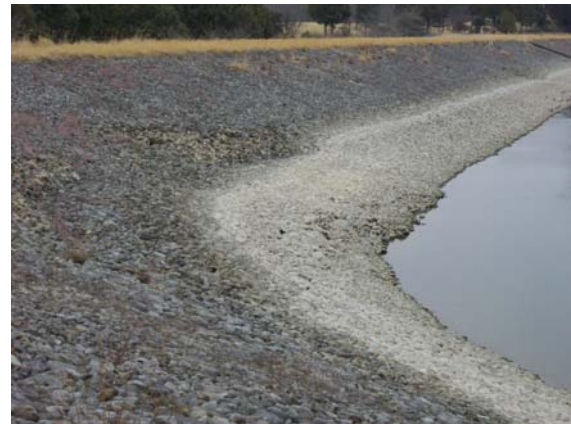
【傾斜遮水ゾーン型の調整池(栃木県)の被災状況】 廻り堰形状の堤体屈曲部における池敷斜面の変状。
