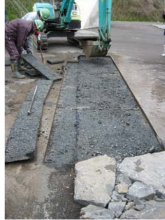
【供用開始前のロックフィルダム(茨城県)の調査状況】 保護アスファルト剥ぎ取り後に路盤のクラックを確認(路盤内の10cm程度の深さにのみ発生)。
