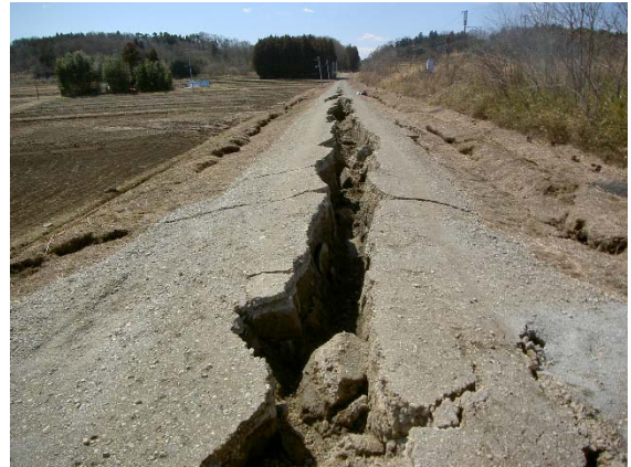
【パイプライン直上に生じた亀裂の発生状況】 パイプラインの浮上によって地表面には幅30cm以上、深さ100cm以上の大きな亀裂が発生。道路側面部は大きく沈下し、周辺地盤も含めた全体が被災している状況を確認。
