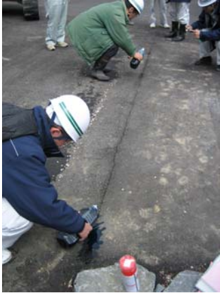
【供用開始前のロックフィルダム(茨城県)の調査状況】 左岸部の地山と堤体との境界部の保護アスファルトに発生したクラック(施工時の継ぎ目に一致)へメチレンブルーを投入。
