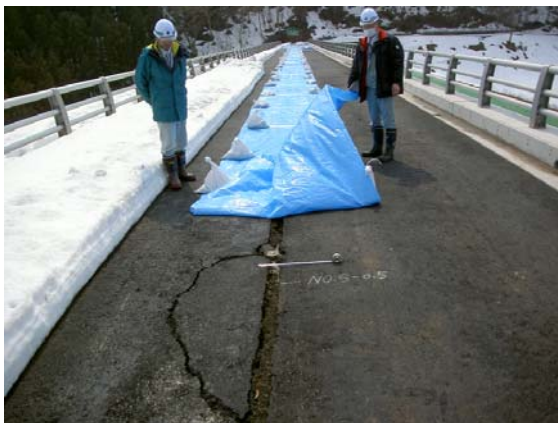
【フィルダム(岩手県)の堤頂縦断ひび割れ】 ダム堤体の堤頂アスファルト舗装が、ダム軸方向にほぼ全長に亘って幅10cm程度のひび割れが発生。ひび割れに雨水が入らない養生と亀裂深さの確認方法について助言。
