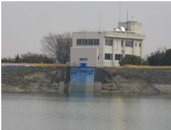
【傾斜遮水ゾーン型の調整池(栃木県)の被災状況】 取水施設の両端に設置されたいたコンクリート斜面保護工の破損と堤体法面の欠損。
