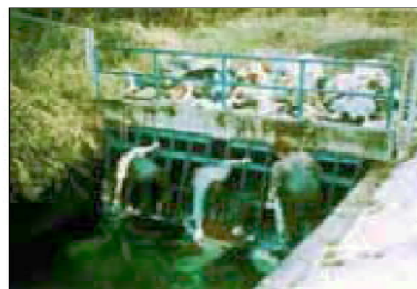
混住化による用排水路へのゴミの流入
