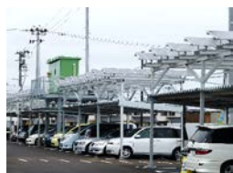
太陽光発電システム
