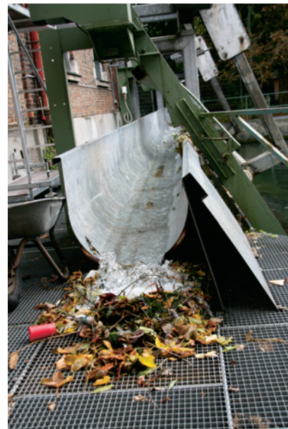
Fig.9 フラッシュタイプの除塵機 Flash-type trash removal screen
