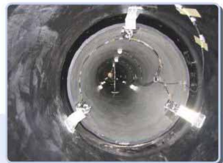
底樋内面(実証試験用センサー設置)
