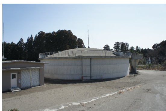
写真9 ファームポンドの周辺の降灰状況
