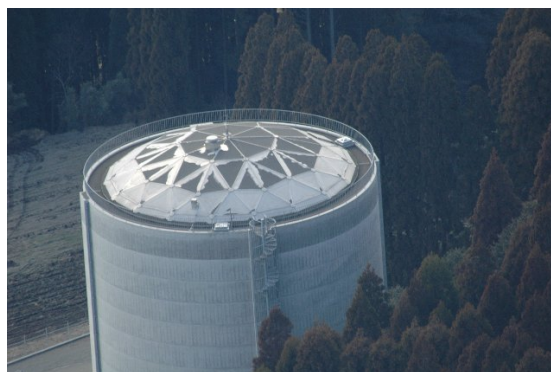
写真7 ファームポンドの天蓋の降灰状況
