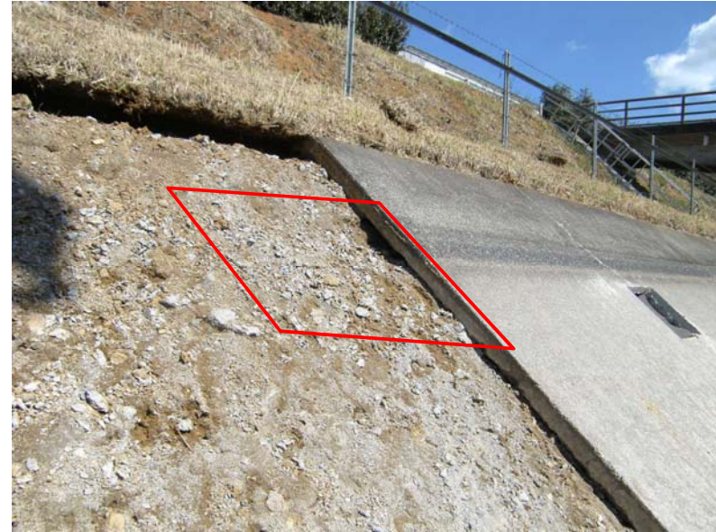
②空洞状況写真
