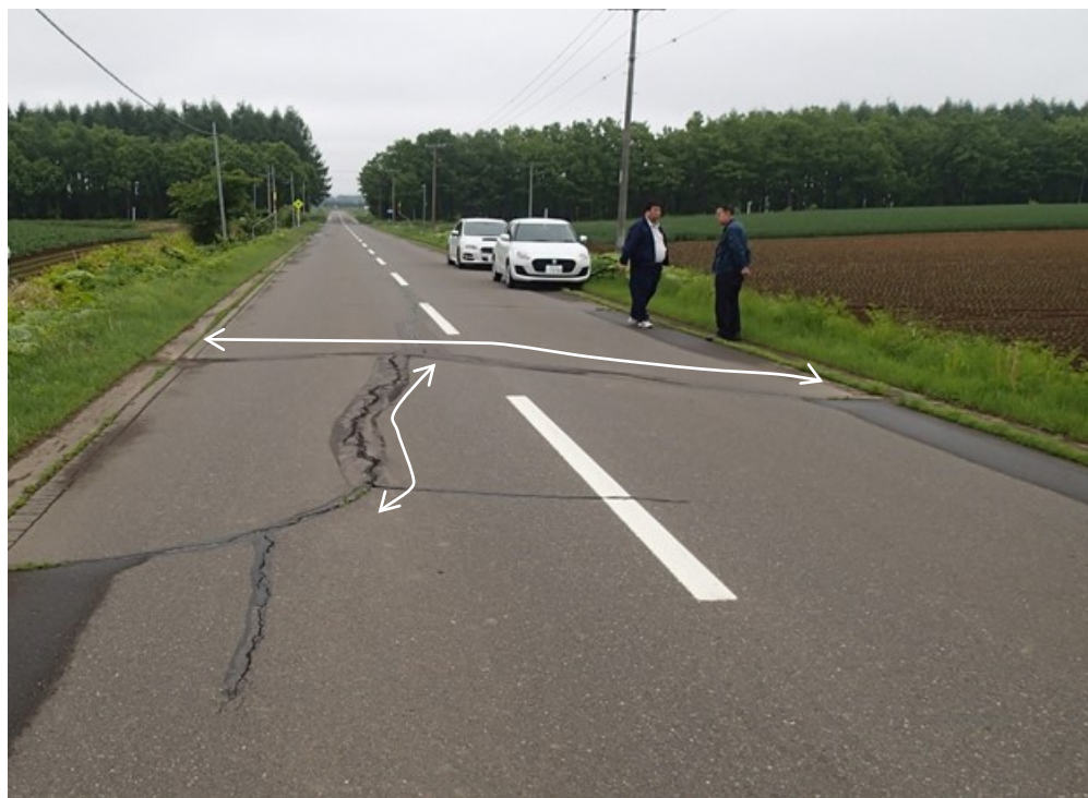
図6 路面全幅及び走行方向にヒビ及びうねり
