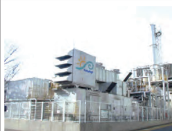
埼玉製作所の コージェネレーション設備
