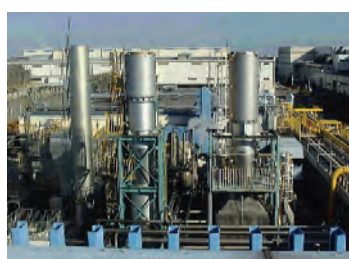
鈴鹿製作所のコージェネレーション設備
