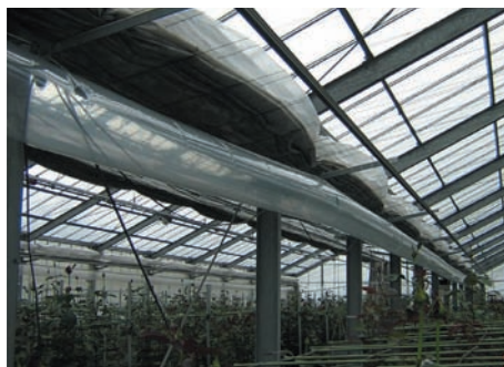
ハウス内ダクト
