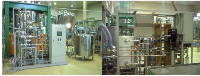
全自動イオン交換クロマト装置 ナノろ過装置 図2 工場規模パイロットプラントの外観
