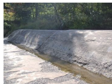
図1 固定堰直下の摩耗の例
