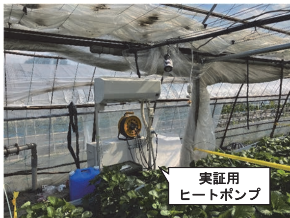
写真1. 実証に使用したヒートポンプ
