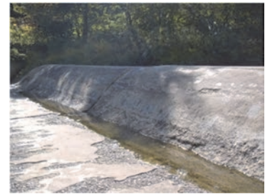
図1 固定堰直下の摩耗の例
