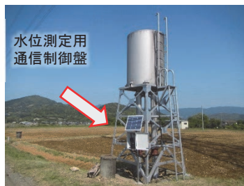
配水槽における水位遠方モニタリング
