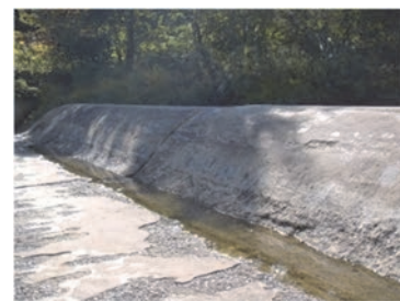
図1 固定堰直下の摩耗の例
